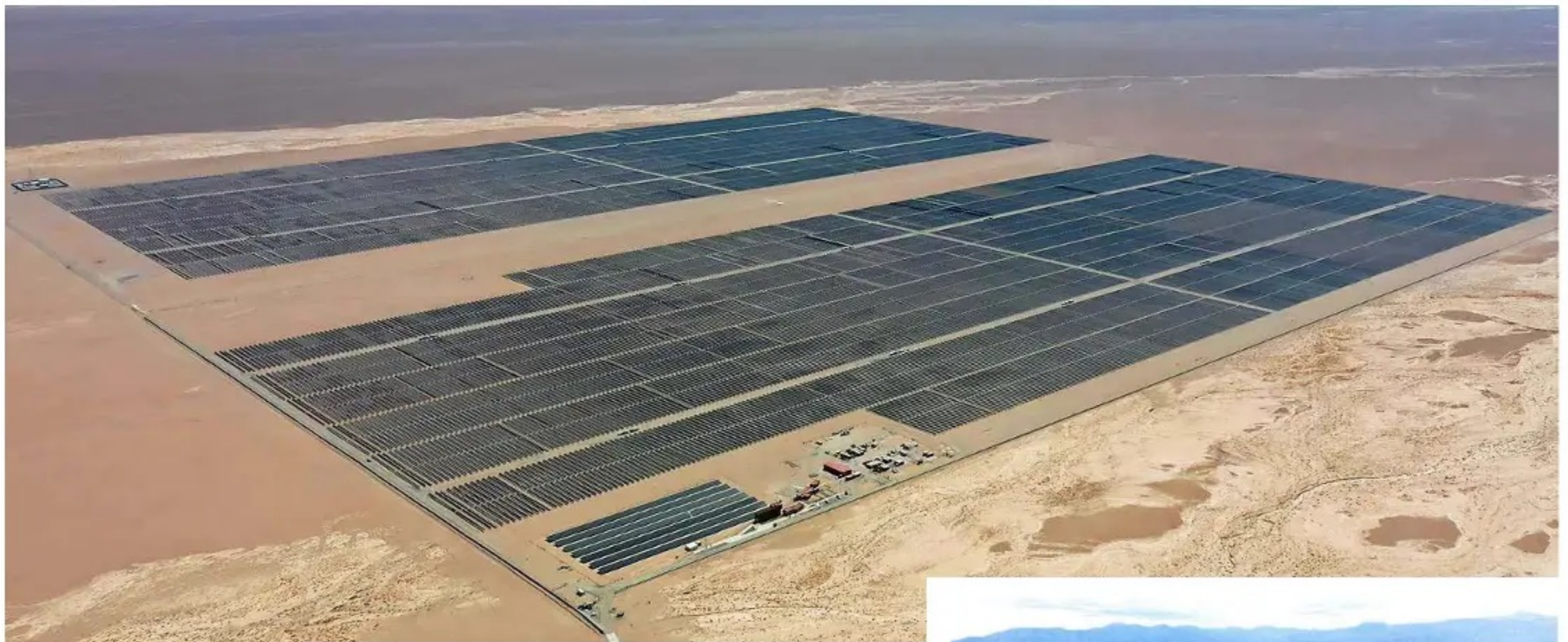
Sonnedix Atacama es la planta solar más grande de la compañía hasta la fecha.
